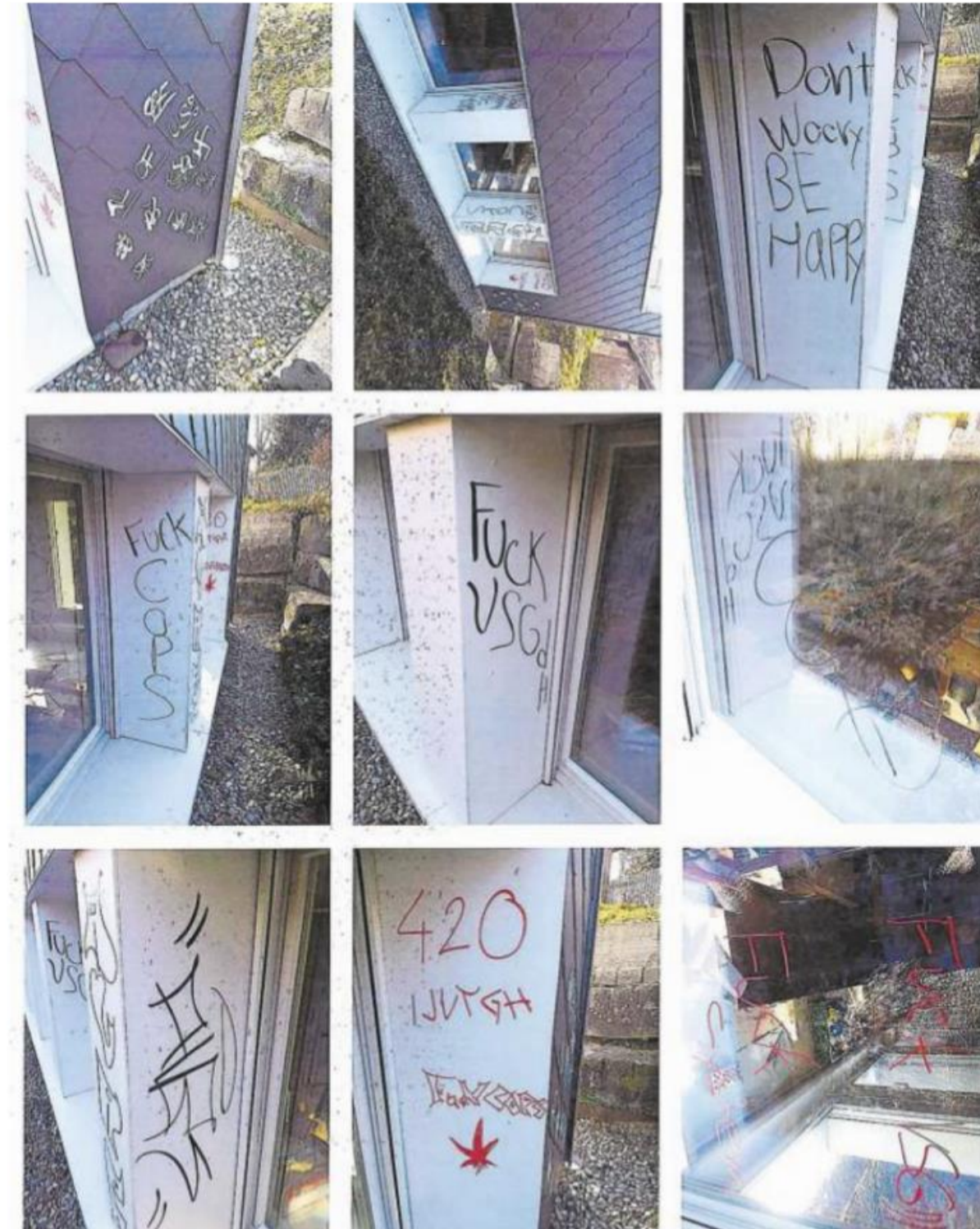
Die Schmierereien auf den Wänden und Fenstern des Primarschulhauses Basadingen.
